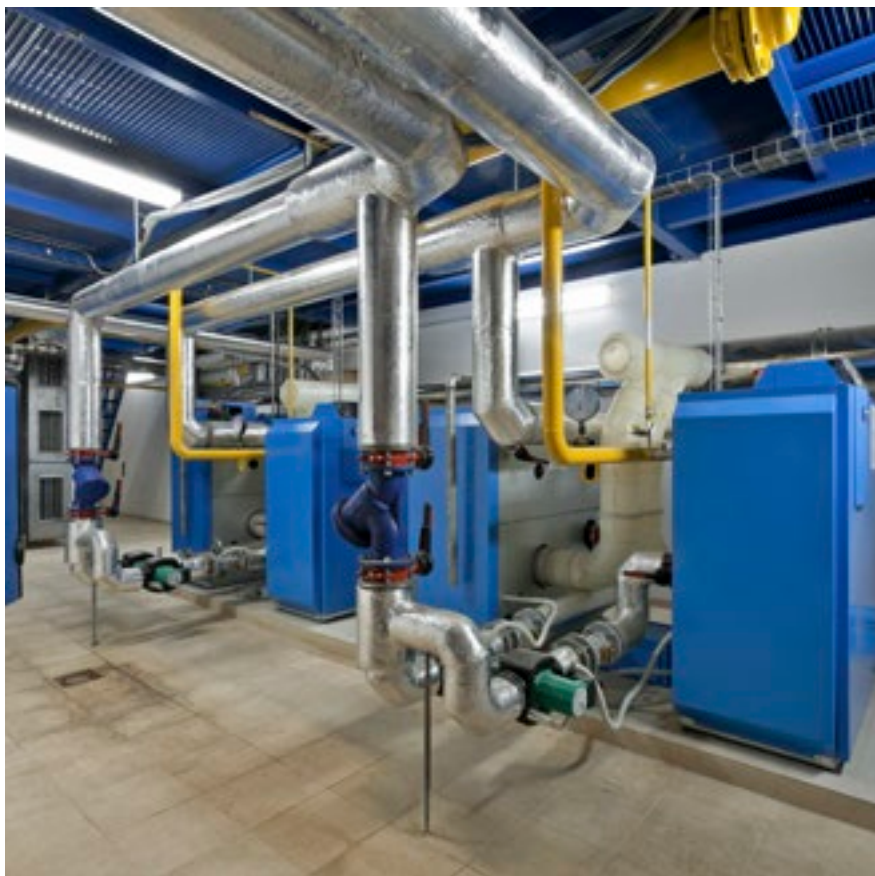
Kavárna SLAVIA Kaskáda stacionárních kondenzačních kotlů 2× Logano plus GB312 – 560 kW
